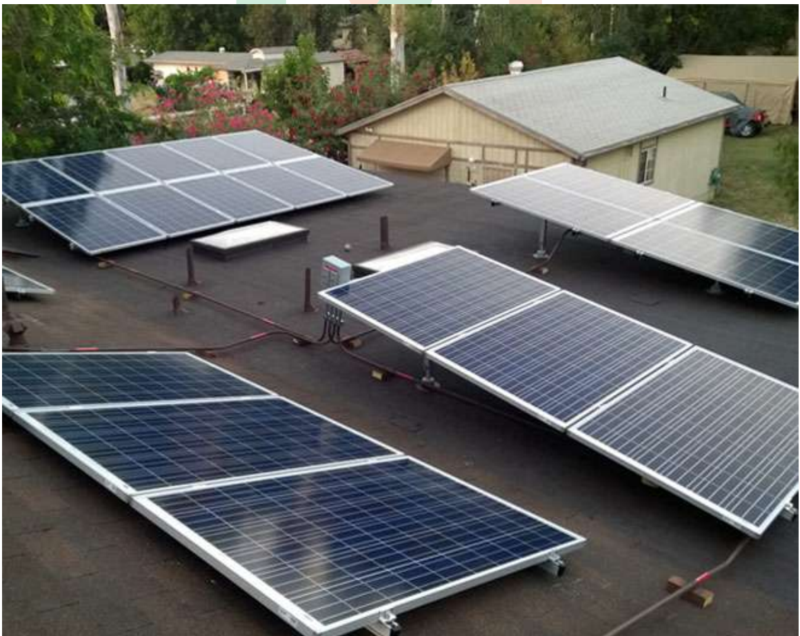
Hệ thống PV Rooftop hộ gia đình
