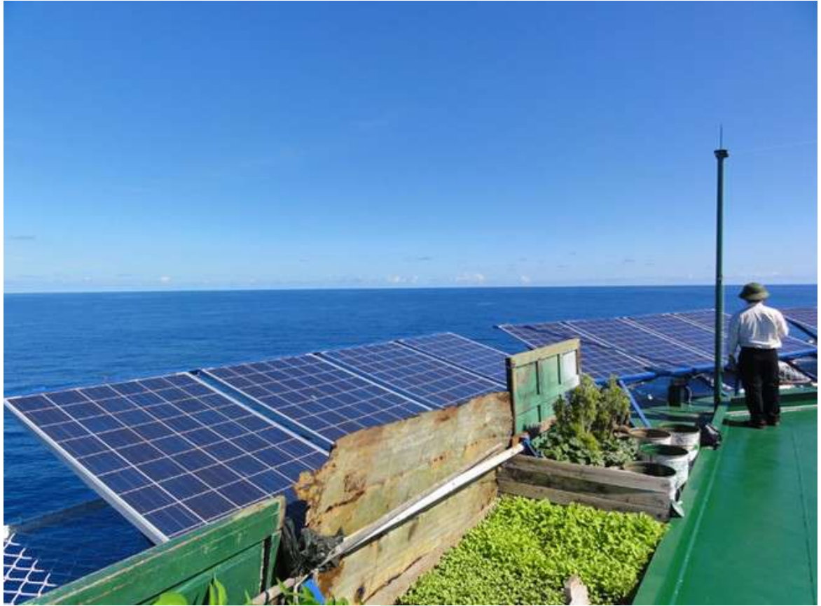
Micro Grid_Cung cấp điện chiếu sáng quần đảo Trường Sa
