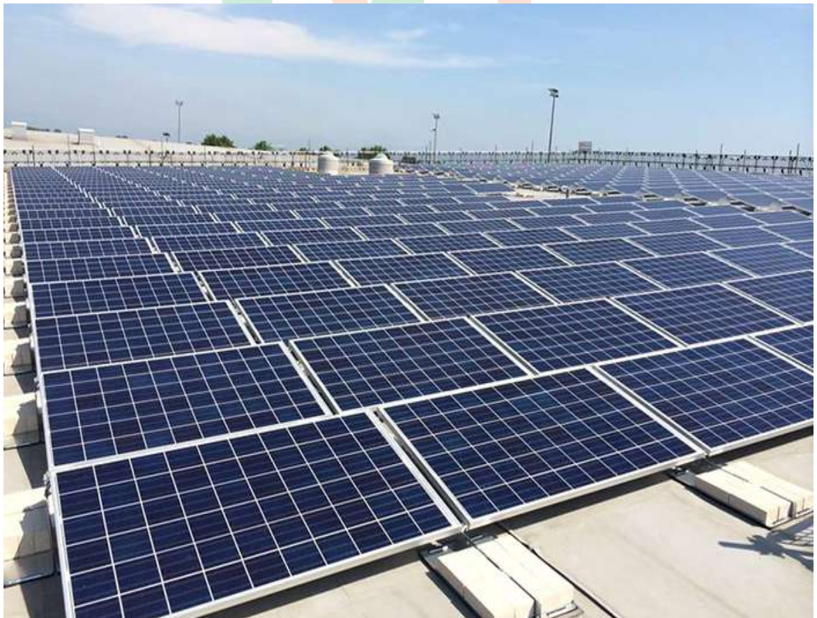
Dự án điện Năng lượng mặt trời
